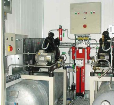
Reciprocating compressor အခန်း
