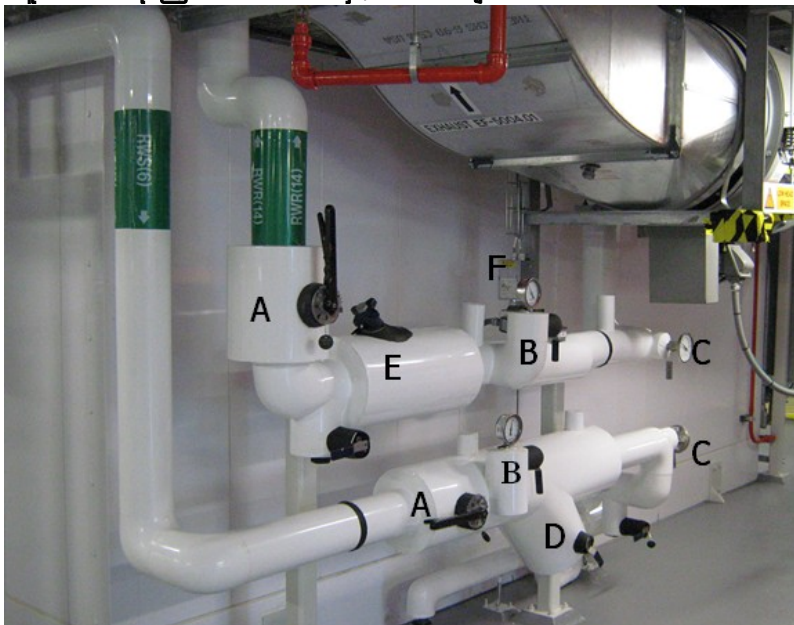
ပုံ ၃-၃၈ AHU နှင့် အတူတပ်ဆင်ထားသည့် pipe ၊ fitting နှင့် device များ
